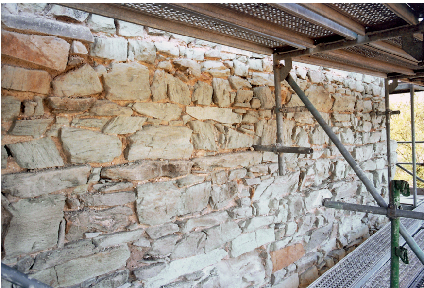
Abb. 4. Mauerwerkspartie auf der Nordseite westlich des heutigen Zugangs. Deutlich erkennbar sind die durchlaufenden Lagerfugen zwischen den Schichtpaketen (Foto: Verf.).
