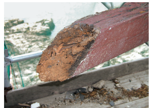
Abb. 30. Auslugerker, verfallener Balken (Foto: wie Abb. 21).
