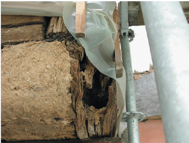
Abb. 80. und 81. Zerstörter Balkenkopf und Fehlstelle im Pfosten.
