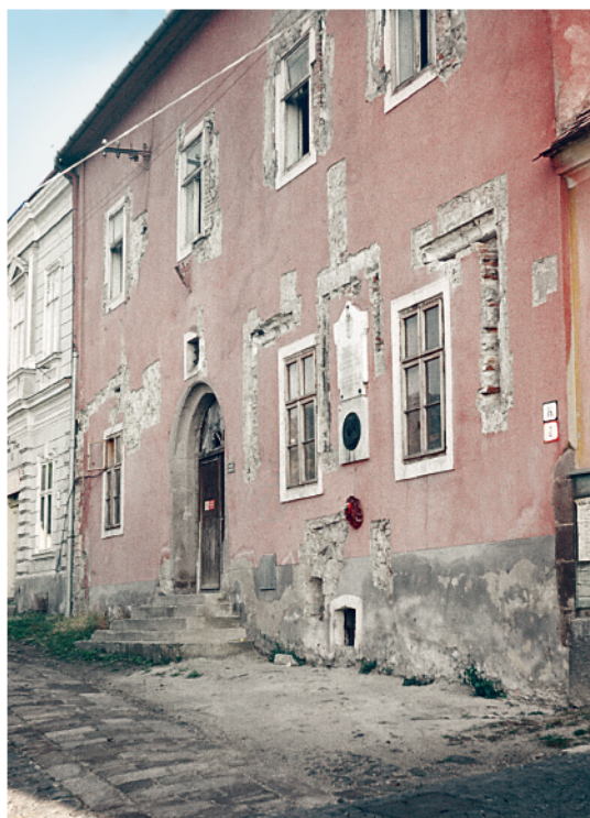
Abb. 1. Kremnitz/Kremnica, „bauforscherisch“ zerfurchte Fassade, 1982.
