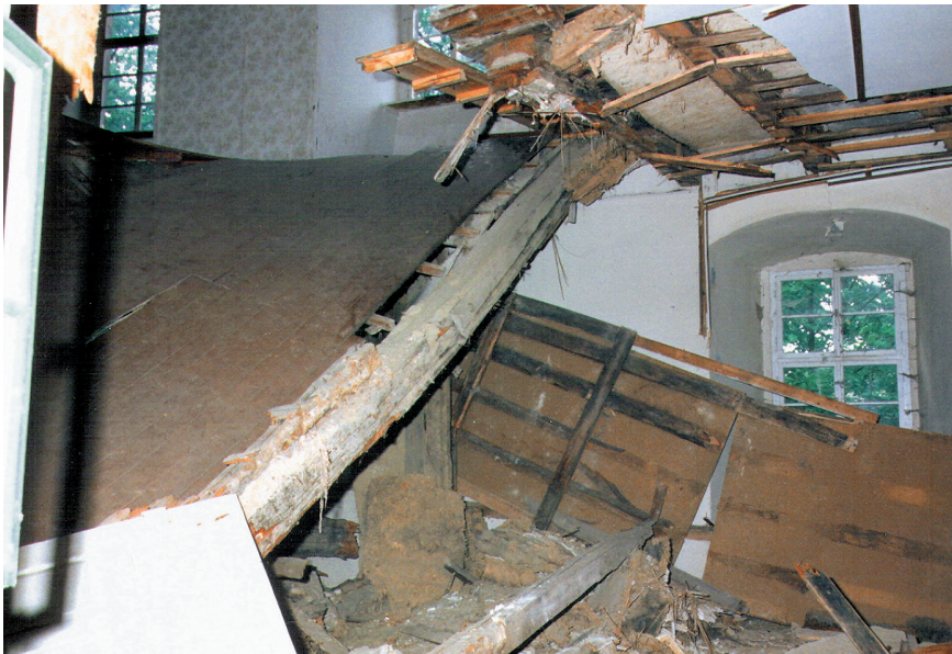
Abb. 6. Schloss Blankenhain, Südflügel. Abgestürzte Geschossdecke nach Schwammbefall (Foto: M. Oppitz, 2000).
