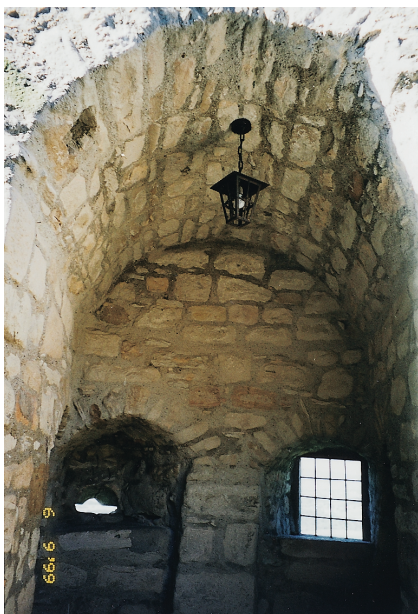
Abb. 11. Fünfeckiger Flankierungsturm, Unteres Wehrgeschoss. Das Fenster in der rechten Schießkammer ist neu eingebrochen (Foto: Verf.).
