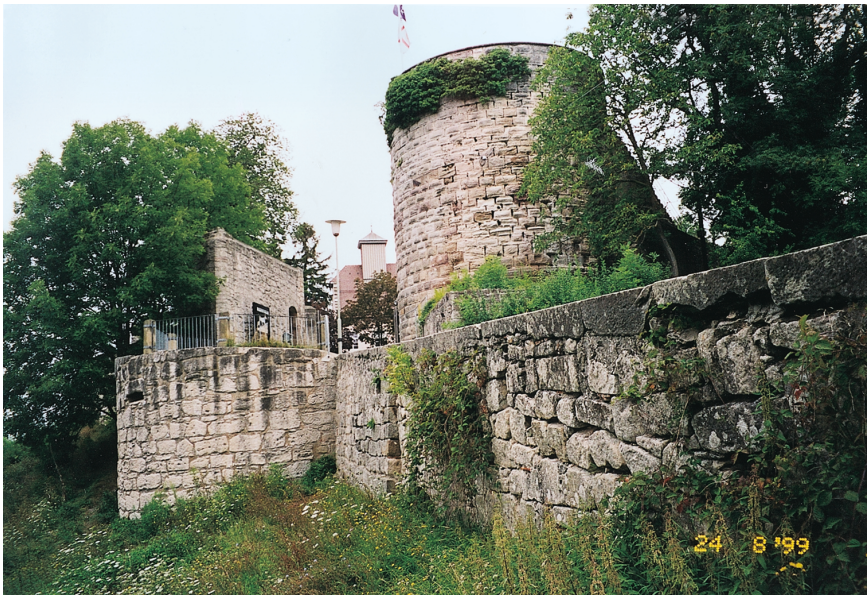
Abb. 3. Bergfried, Außenseite (Südost), davor die Brücke; links der Stumpf vom südlichen Rundturm des Torbaues (Foto: Verf.).
