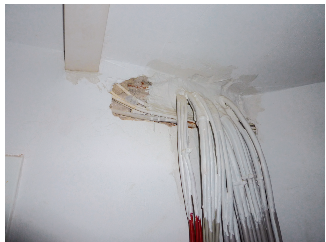
Abb. 23. Unsachgemäße Leitungsschottungen sind nachzubessern. (Foto: Verf.).
