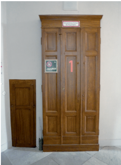
Abb. 21. Trockene Steigleitung, in einem historischen Wandschrank untergebracht (Foto: Verf.).
