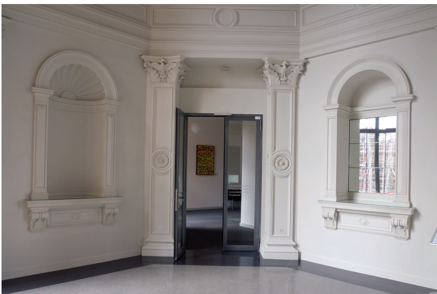
Abb. 19. Neu eingebaute Rauch- bzw. Feuerschutzabschlüsse zu Treppenanlagen (Foto: Verf.).
