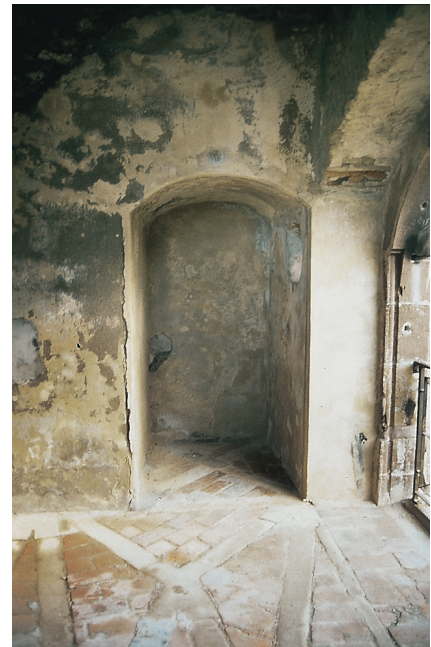
Abb. 9. Nische in der Ostwand; darin rechts der Oculus. Rechts im Bild der profilierte Sandsteinbogen zum Saal hin. Im Vordergrund der mit Rippen aus Sandstein und Backsteinen ausgelegte Boden (Foto: Heiko Wagner, Nov. 2002).
