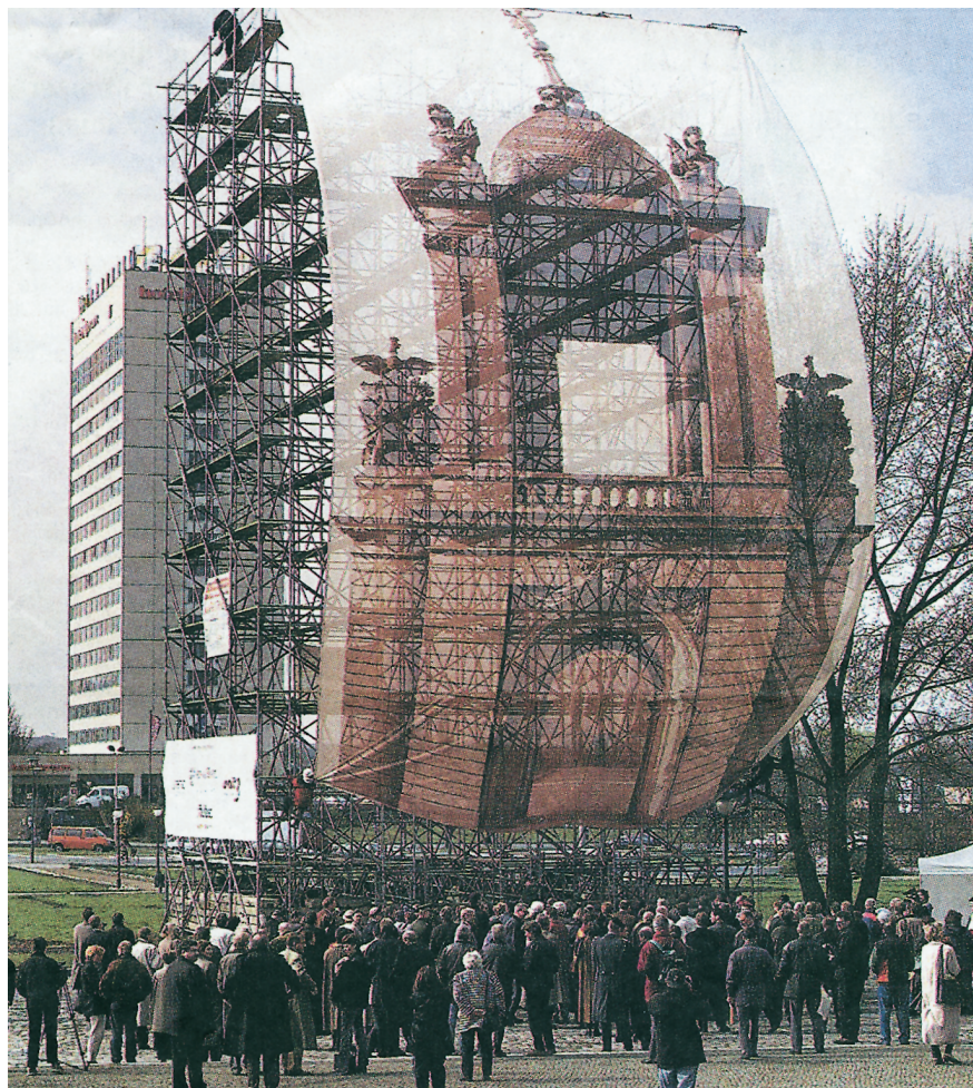
Abb. 6. Das Fortunaportal als Baumasker (Pressefoto: Littwin, in: Die Welt, Freitag, 14. April 2000, S. 48). Die symbolische Grundsteinlegung erfolgte am 1. September, der „Erste Spatenstich“ zur Aufschließung der Fundamente am 8. September 2000. Im Jahre 2002 – ein Jahr nach dem 300jährigen Preußenjubiläum – soll sie wieder entstanden sein: die architektonische Zierde des Alten Marktes.
