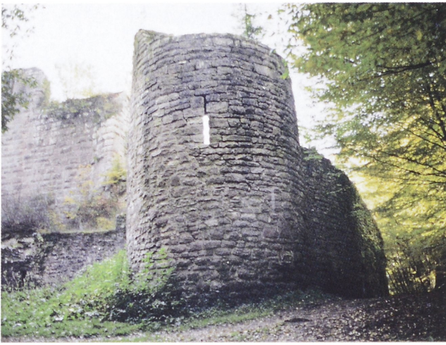
Abb. 5. Burgruine Waldeck bei Calw/Schwarzwald. Zwingermauer mit Halbschalenturm der Hauptburg, im Hintergrund Mauerreste der inneren Burg (Foto: Verf., 1996).
