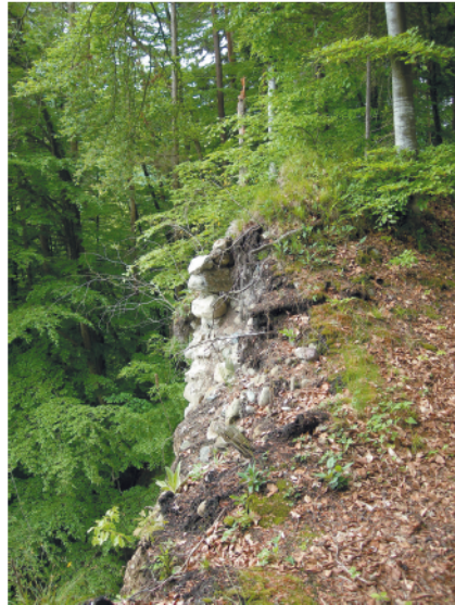
Abb. 4. Durch Erosion gefährdete Fundamentreste des Hauptgebäudes der Burg Neu-Summerau (Foto: Verf., 2006).
