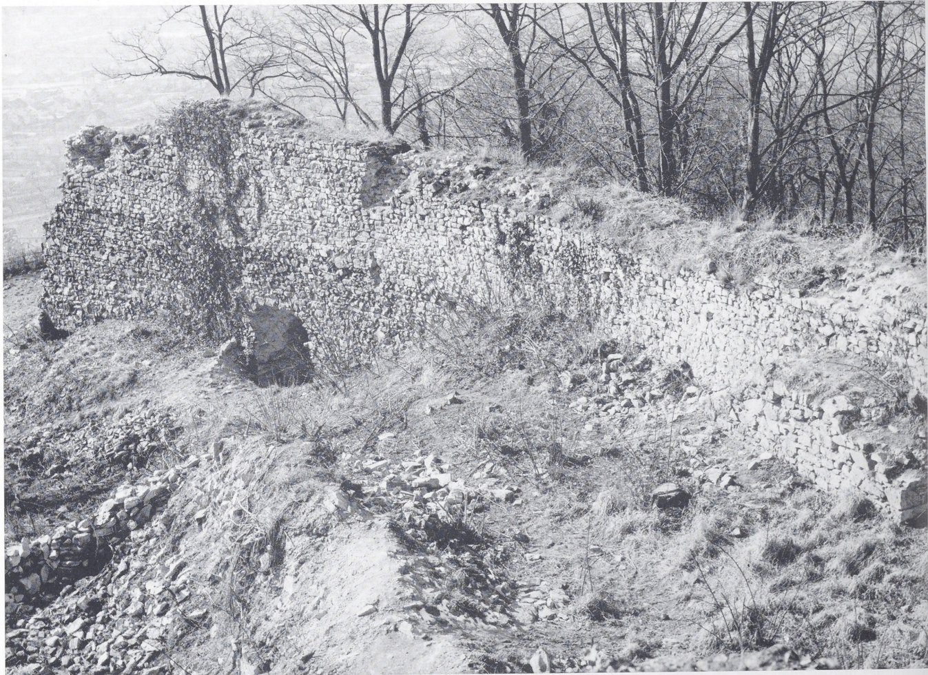
Abb. 1. Ruine Schauenburg bei Dossenheim, Rhein-Neckar-Kreis; Blick auf die innere Umfassungsmauer, die zahlreiche Schäden zeigt: oberer Abschluß und Verputz fehlen, äußere Mauerschale teilweise ausgebrochen, Mörtel zwischen den Steinen stark ausgelaugt. (Foto: Landesdenkmalamt Baden-Württemberg, Karlsruhe, 79 A 152, 1979).
