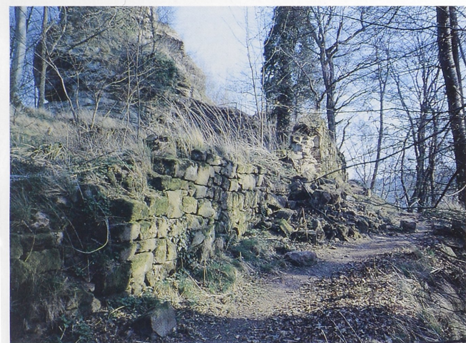
Abb. 3. Vorwerkmauer nach Westen, Blick in nördlicher Richtung: ausgespülter Mauermörtel und Erddruck als Auslöser einer Kettenreaktion (Foto: H. Hofrichter, 21. 2. 1990).
