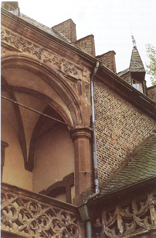
Abb. 6. Burg Binsfeld. Abbruchstelle des oberen Arkadenbogens an der Loggia des Herrenhauses und ergänzter Maßwerkfries (Foto: Verfasserin).
