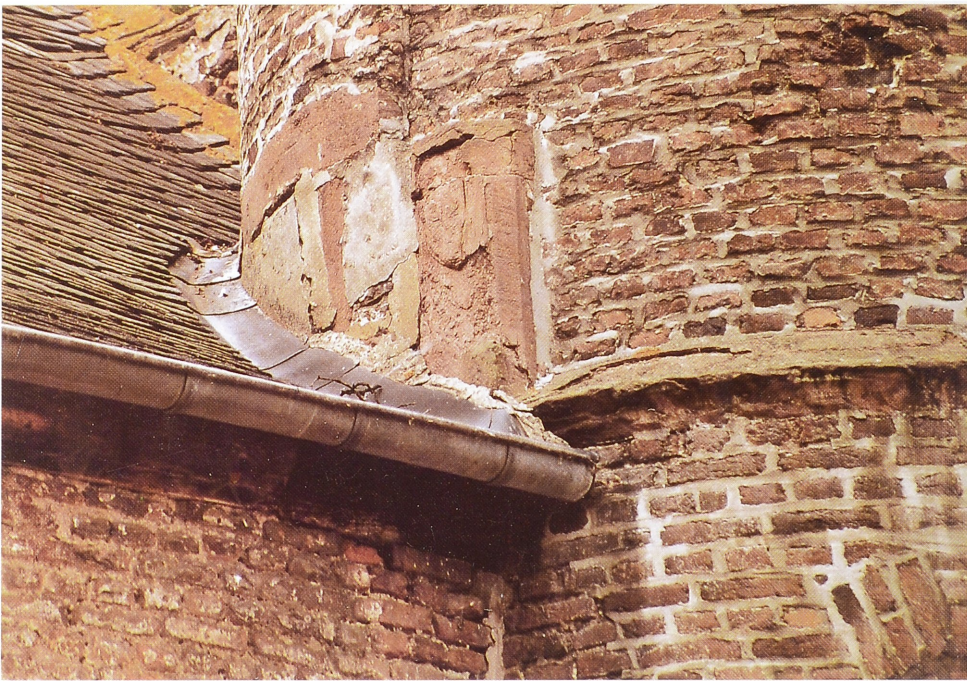
Abb. 5. Burg Binsfeld. Tür und Abbruchstelle der Loggia des westlichen Anbaus (Foto: Verfasserin).
