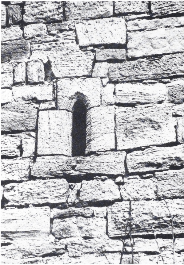
Abb. 6. Treppenhausfenster V. (Foto: Preiser).
