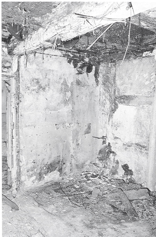
Abb. 1. Denkmalpflegerischer Alltag: schmerzhaft Substanzverluste durch unterlassene Hilfeleistung (Foto: Hofrichter 1992).
