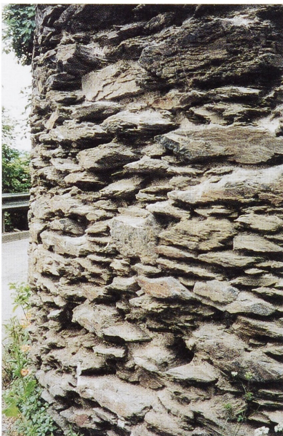
Abb. 6. Mauerwerkszerfall im Sockel- und im Fensterbereich (Foto: Hoga).
