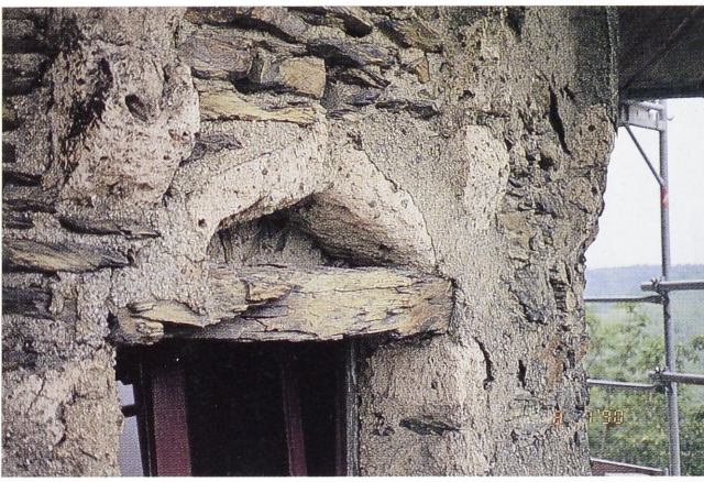
Abb. 5. Mauerwerkszerfall im Sockel- und im Fensterbereich (Foto: Hoga).
