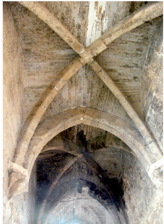
Abb. 6. Westlicher Arkadengang mit noch intakten Rippen.
