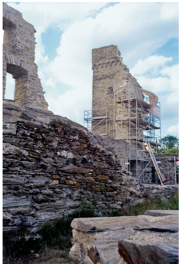
Abb. 3. Kastellaun (Rhein-Hunsrück-Kreis), Burg. Palasbereich und Wohnturm aus südlicher Richtung. Die linke vordere Wandscheibe lässt noch den durch Auswitterung und Auswaschung verursachten Zustand vor der Neuverfugung erkennen.
