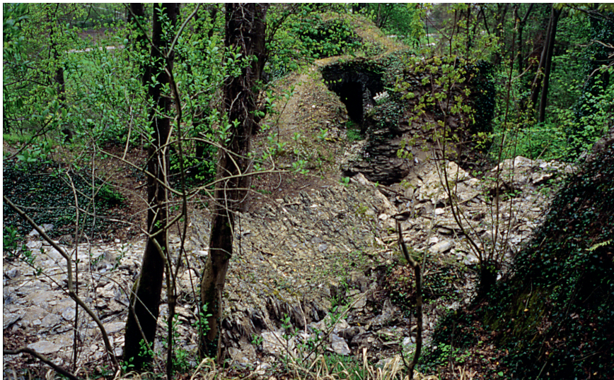
Abb. 7. Nassau (Rhein-Lahn-Kreis), Burg Stein. Infolge Erdbebens (?) umgekipptes Wandstück der Mantelmauer. Im Hintergrund der in die Zwingeranlage eingebundene Torturm.
