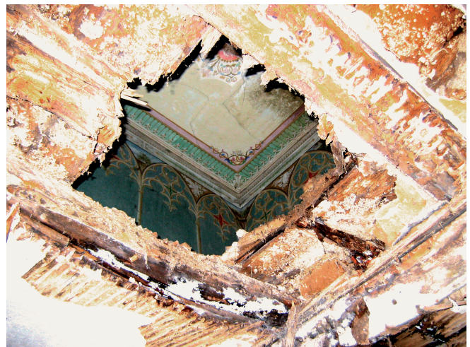
Abb. 3. Weckbeckerschlösschen, zerstörte Balkendecke zwischen Erdgeschoss und Belétage (Foto: Verf., 2009).
