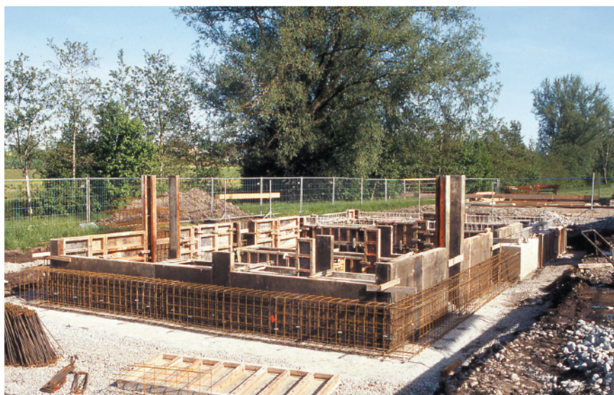
Abb. 4. Blick auf den Bauplatz des Bauernhauses an der Ostseite der Vorburg mit der begonnenen Fundamentierung. Unsichere Bodenverhältnisse und statische Vorgaben verlangten starke Betonfundamente, auf denen dann aber die oberträgigen hölzernen Baukonstruktionen ohne moderne Verstärkungen aufgestellt werden konnten (Foto: Verf.).
