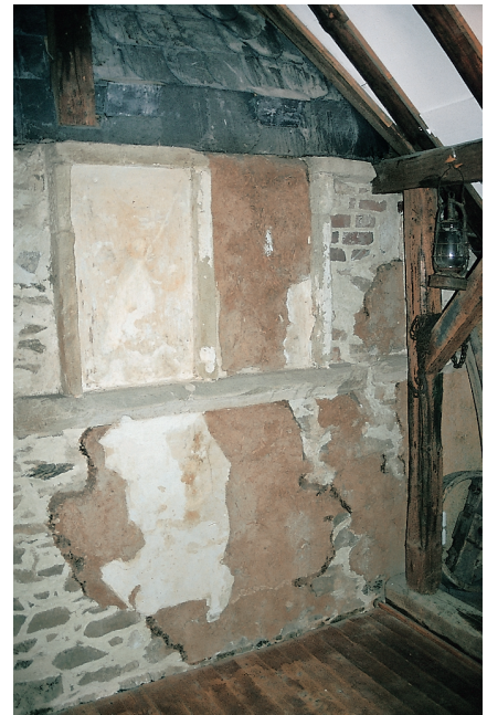
Abb. 11. Schloss Mengerskirchen. Im Dachgeschoss des Hauptgebäudes sind Reste des zum angrenzenden Nordwestturm gehörenden Wehrgangs erkennbar (Foto: Verf., 2000).
