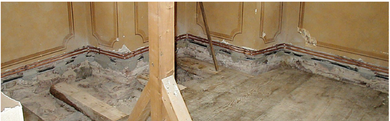
Abb. 20. In hochwertigen Räumen bestand die Schlösserverwaltung auf Unterputzverlegung; die damit zwangsläufig gegebenen Baueingriffe, Kostensteigerungen und Wirkungsverluste bei der Abstrahlleistung wurden aus gestalterischen Gründen hingenommen.
