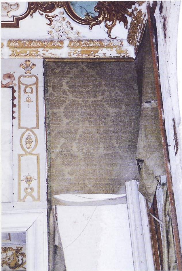
Abb. 1. Schloss Alteglofsheim, Schädigungsbild vor der Wiederherstellung (Foto: Eschke).
