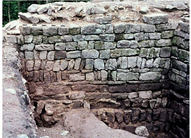
Abb. 15. Fundamentmauerwerk des Wohnturms bei Karlsbad-Langensteinbach (Regierungspräsidium Karlsruhe, Referat 26 – Denkmalpflege, Archäologie des Mittelalters).
