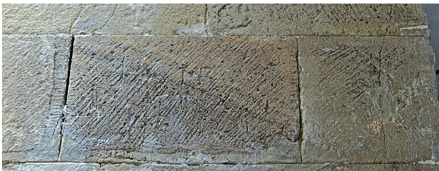
Abb. 17. Ehemalige Stiftskirche in Sinsheim (um 1100). Mauerwerk an den Pfeilern der Langhausarkaden.
