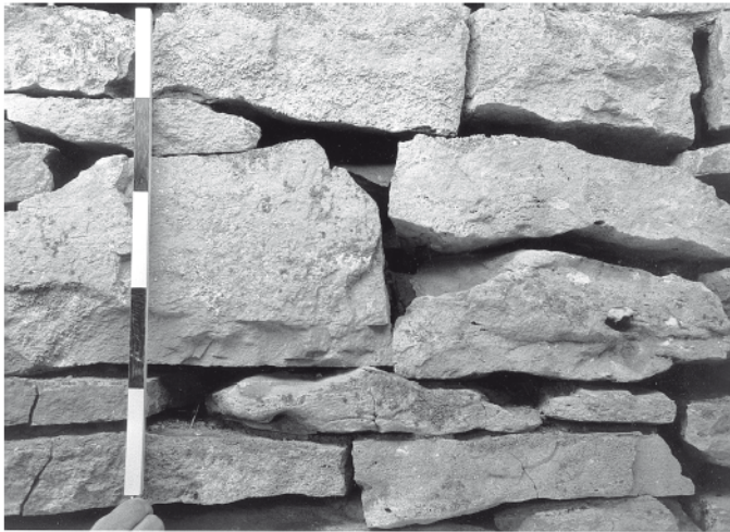
Abb. 23. Burg Brauneck, Schildmauer, Schadensbild, Mauergefüge mit tiefreichendem Mörtelverlust, Zustand 1982.
