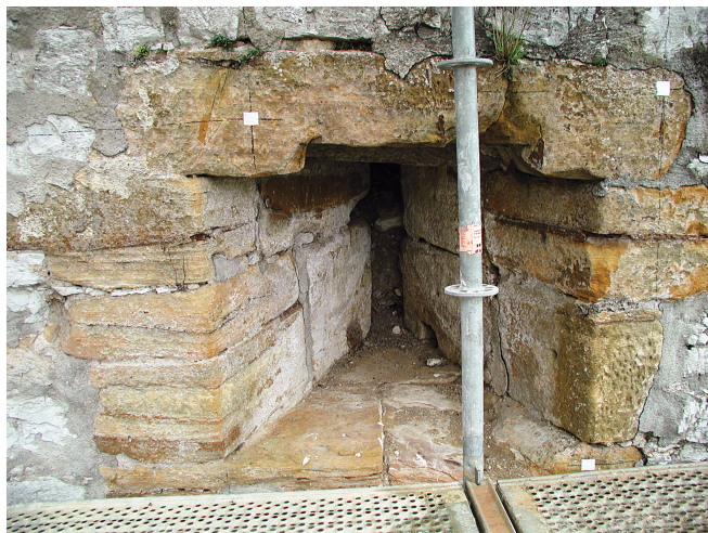
Abb. 24. Burg Rechberg, „Untergeschoss der Schenke“, Scharte (8.3.02) von außen her, die Innenseite ist mit Schutt hinterfüllt und deshalb nicht zugänglich (Foto: Verf.).
