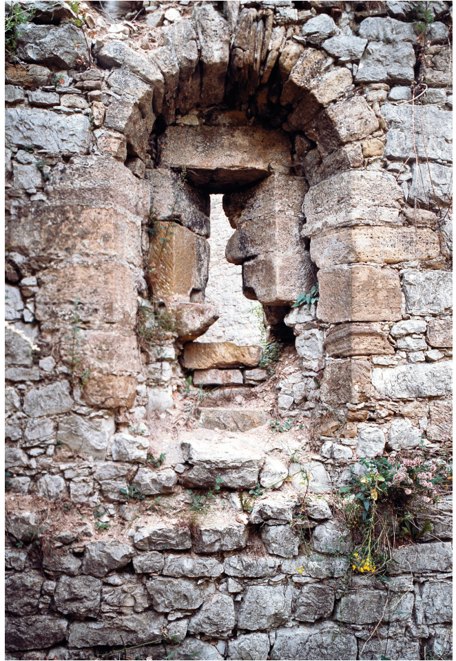
Abb. 23. Burg Rechberg, Nordturm, Innenseite vor der baulichen Sicherung, Scharte 5.2.23 mit den von Anfang an vorhandenen scharfkantigen Aussparungen für Prellhölzer (Foto: Verf., 1994).
