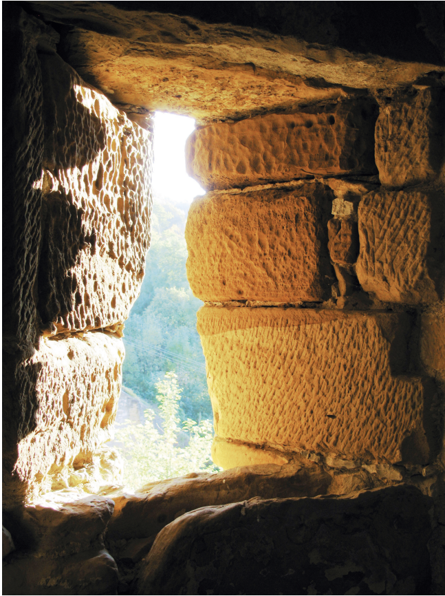
Abb. 22. Burg Rechberg, Maschikuliturm, Innenansicht der Scharte 3.2.19. Trotz der Verwitterungsschäden sind die groben Werkspuren ablesbar, auf der Brüstung die Rinne für das Prellholz (Foto: Verf.).
