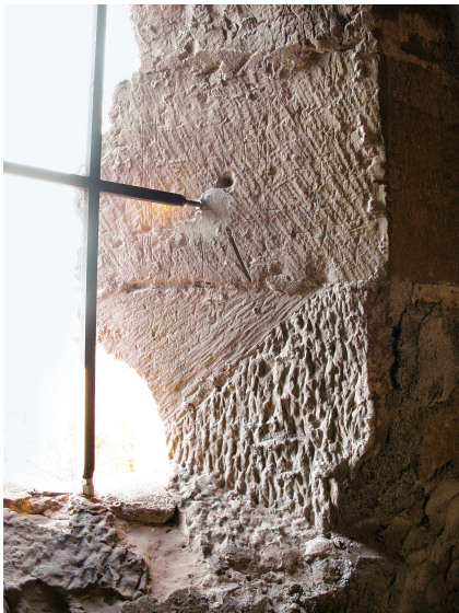
Abb. 19. Burg Rechberg, Torhaus, Fußpunkt der Scharte 1.2.07 von innen. Man erkennt die abgespitzte Brüstung und sieht darüber die älteren „Werkspuren“, von der Fläche und der Zahnfläche herrührend (Foto: Verf.).
