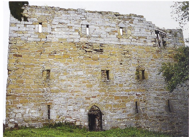
Abb. 2. Burgruine Straufhain. Ostwand des Wohnbaus. Im Erdgeschoss sind Scharten und Spitzbogenpforte erkennbar. Darüber zwei quadratische Fenster und zwei Doppelfenster, im zweiten Obergeschoss zwei Fenster mit Dreiecksturzh (Foto: Verf., 2000).
