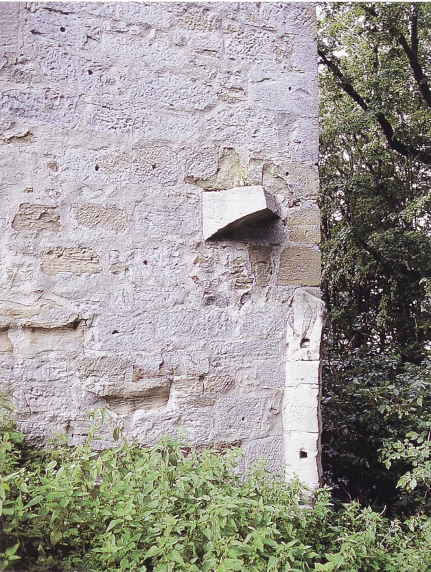
Abb. 12. Burgruine Straufhain. Nordostecke des Wohnbaus mit Resten des Torbogens und des Gewändes (Foto: Verf., 2000).
