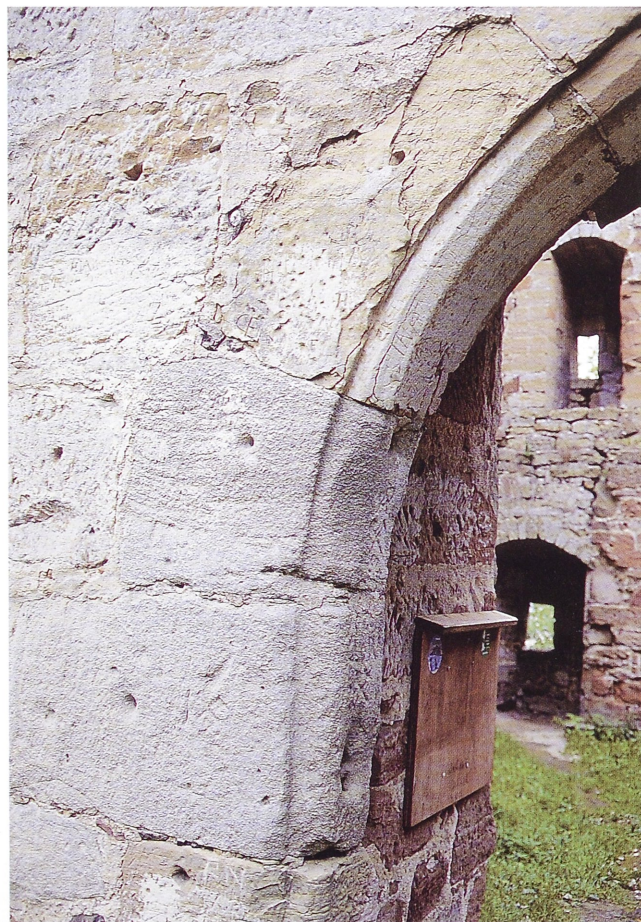
Abb. 4. Burgruine Straufhain. Gewände der Sandsteinpforte; der obere Teil ist eindeutig erneuert (Foto: Verf., 2000).
