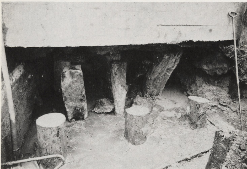
Abb. 4. Burg Vischering. Ringmauer mit neuem Ringanker aus Stahlbeton über ausgeknickten alten Holzpfehlern und über neuen Rammpfählen, 1928 eingebaut
