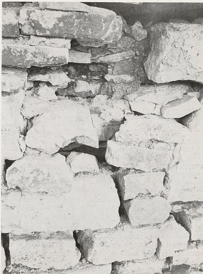
Abb. 17. Mauerzustand im oberen Bereich des Turmschaftes, Befund O an der Südwest-Seite, siehe auch Abb. 5 (Foto: Pfefferkorn)
