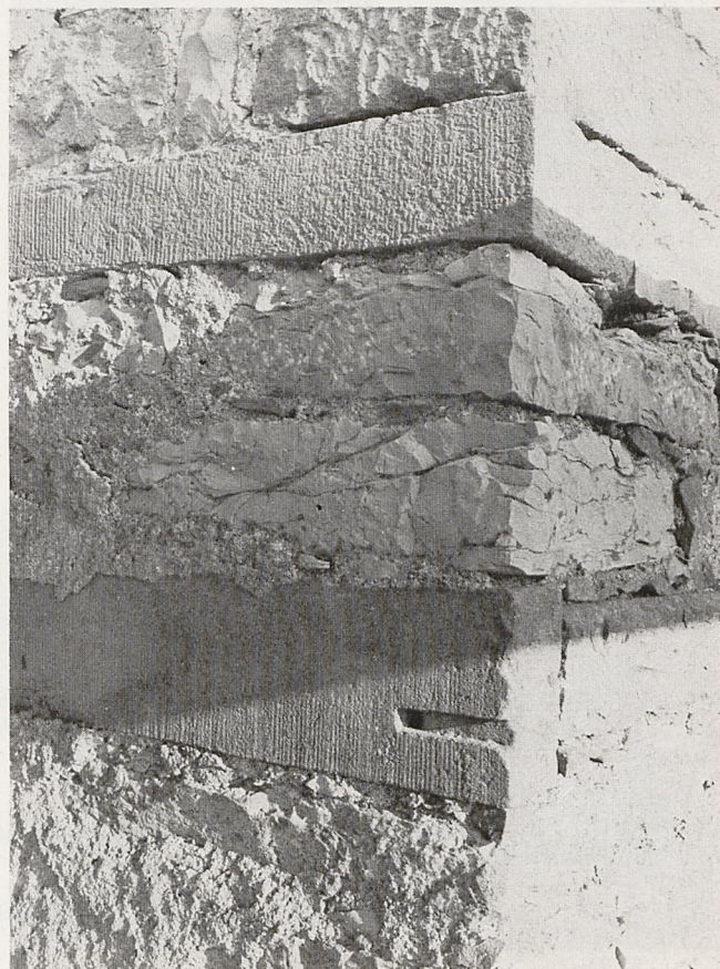
Abb. 14. Spolien an der Westecke; Befund Nr. 2 und 3 (Foto: Pfefferkorn)
