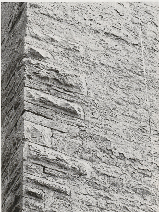
Abb. 18. Eckbuckelquader neben anschließendem hammerrechten Mauerwerk mit Resten alten Verputzes, etwa auf halber Höhe des Turmschaftes (Foto: Preiser)
