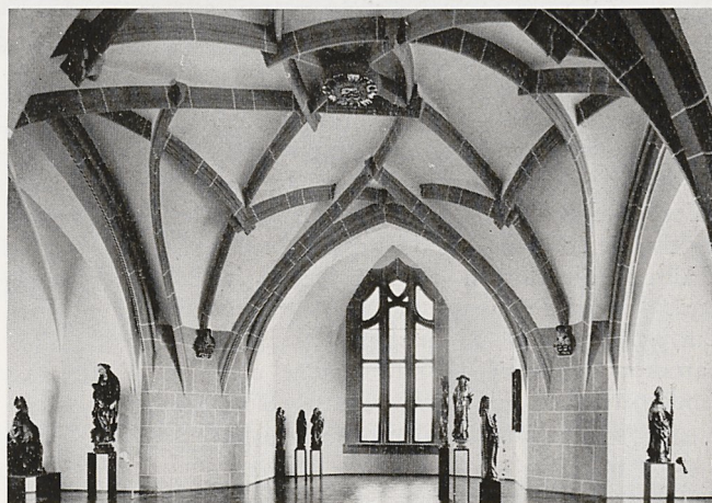
Meißen. Albrechtsburg, Wappensaal (Zustand nach der Restaurierung) Foto: Hochschulbildstelle Univ. Halle, U. Lindner
