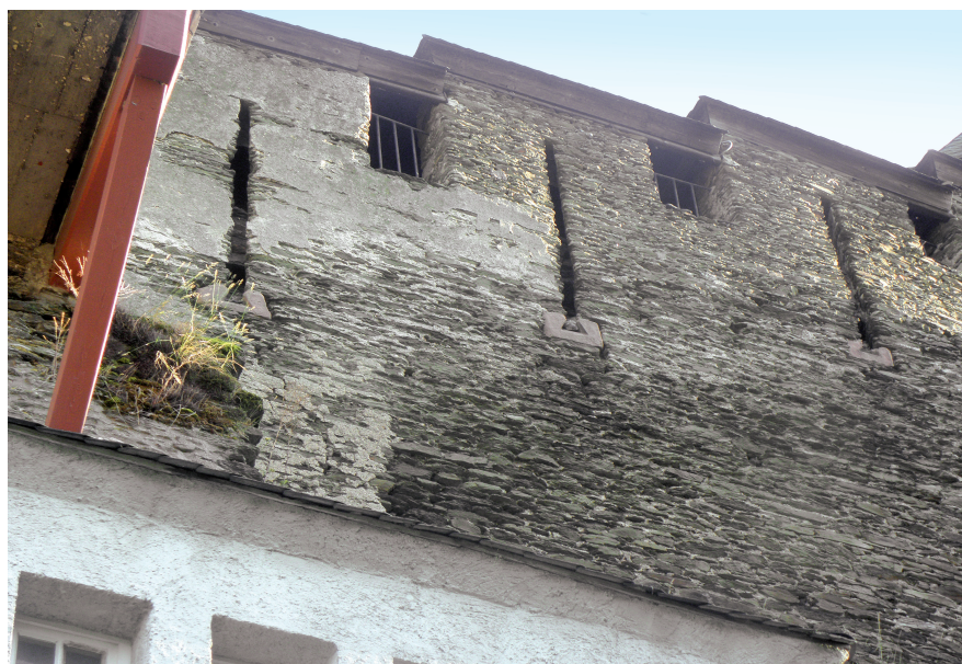
Abb. 10. Original erhaltene Schießscharten mit trapezförmiger unterer Erweiterung aus Sandstein in der nördlichen Ringmauerflanke, vermutlich aus dem 14. oder frühen 15. Jahrhundert (Foto: Verf.).
