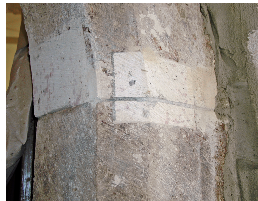
Abb. 13. Hilbersdorfer Tuff als Vierung (= mit Originalmaterial vorgenommene Ausbesserung) in der Torhalle am spitzbogigen Eingang zum Trauzimmer.
