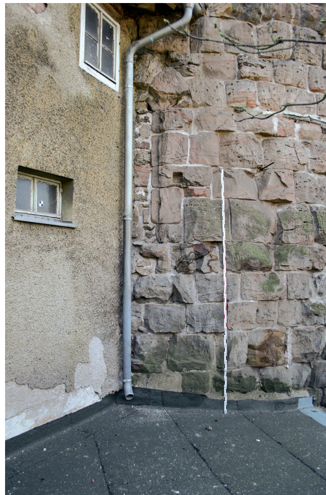
Abb. 9. Schloss Tonndorf, Bergfried, zugesetzte Pforte auf der Nordostseite. Mit dem Einbruch der Pforte (im 16. Jahrhundert?) wurde der primäre Abort aufgegeben und fortan als Durchgang genutzt; die Zusetzung erfolgte vermutlich im 17. Jahrhundert.
