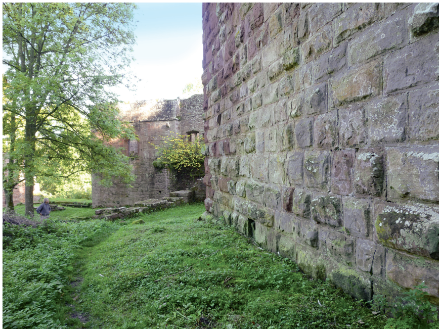
Abb. 4. Buckelquader-Schichten der gleichen Außenwand des Wildenberger Bergfrieds wie bei Abb. 3. Die Schichten verlaufen horizontal völlig ungestört, was gegen die Möglichkeit von Setzungen spricht.
