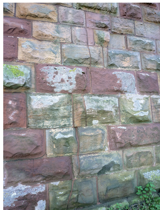
Abb. 3. Buckelquader-Schichten des Wildenberger Bergfrieds mit langem, teilweise die Buckelquader spaltendem Riss.
