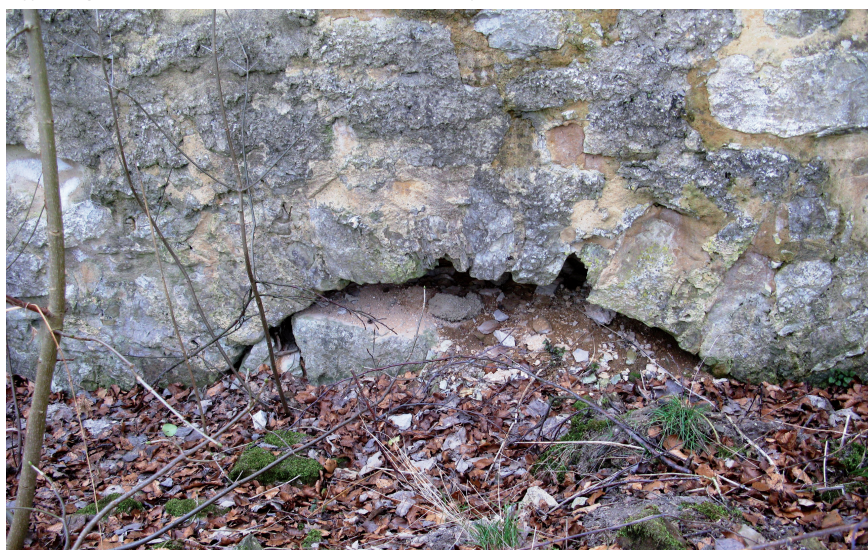
Abb. 25. An der Außenseite der äußeren Zwingermauer erkennbar ein verfüllter Bogen. An der Innenseite gibt es ein Gegenstück, d. h. es war eine durchgehende Öffnung, nicht nur eine Nische (Foto: Verf., 2013).
