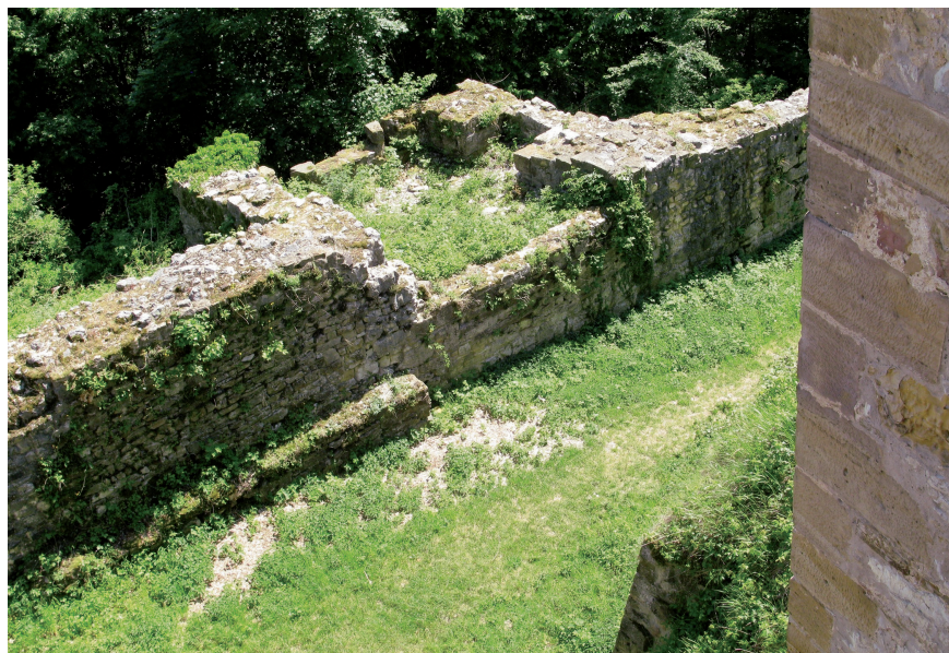
Abb. 11. Die Ruine des Turms G innerhalb der äußeren Zwingermauer sieht von innen bzw. von oben unproblematisch aus (Foto: Verf., 1994).
