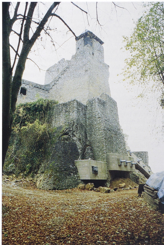
Abb. 23. Burg Hohlenfels, Taunus. Ankerbalken aus Stahlbeton mit Spannungsmessern und Justiereinrichtung im Halsgraben unterhalb der 1978 teilweise eingestürzten Schildmauer; Felssicherungsmaßnahme 1993 (Foto: Verf.).
