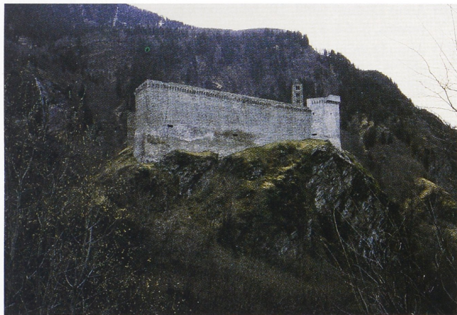
Abb. 11. Castello Mesocco. Ansicht von Nordwesten nach der Konservierung der Mauern. Links die problematischen Felspartien. Unterhalb der Schießscharten links und Mitte die gesicherten Mauerausbrüche (Foto: Verf.).
