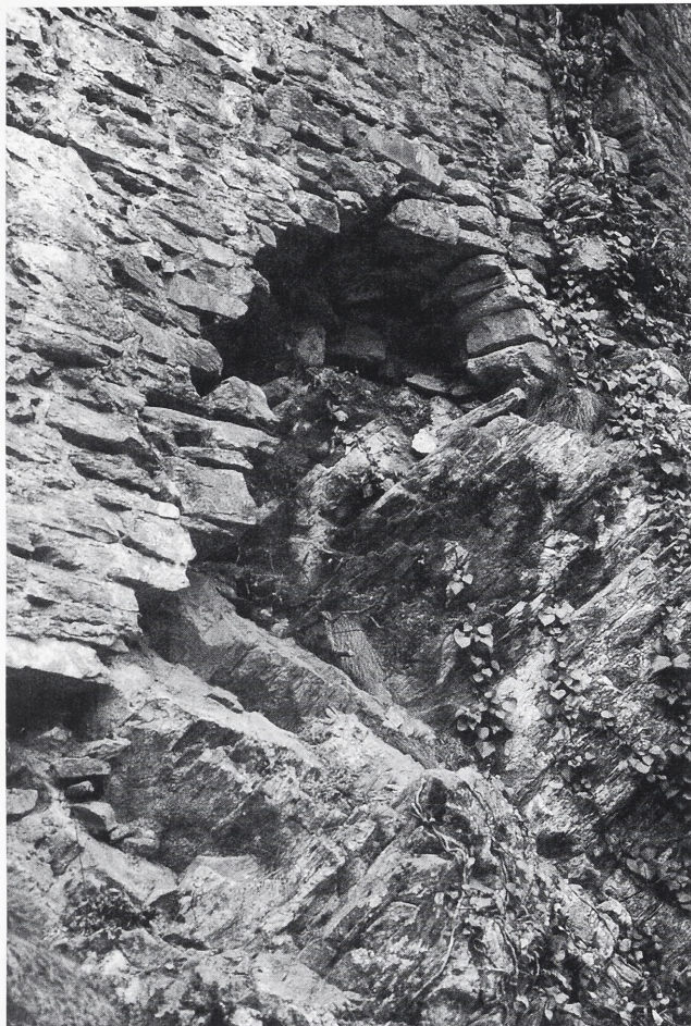
Abb. 4. Castello Mesocco. Mauerwerks- und Felsschaden beim Nordturm (Foto: Högl).
