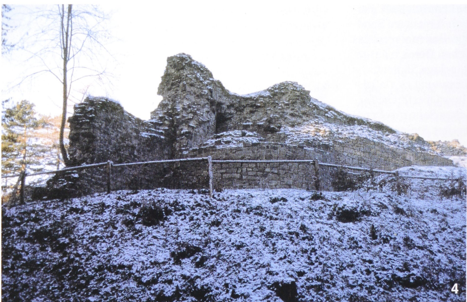
Abb. 7. Blick von Südosten auf die sanierte Mauerschale der südlichen Ringmauer der Hauptburg (Foto: Verf.).
