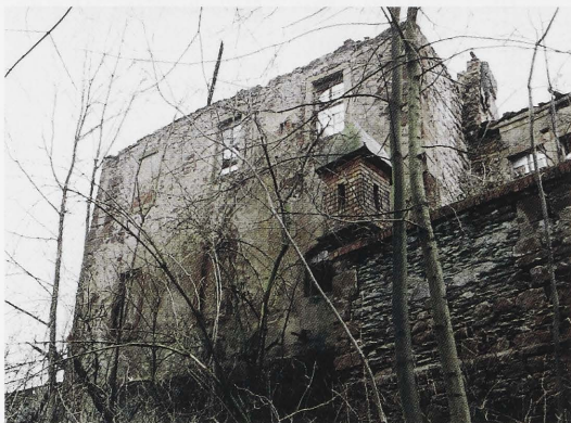
Abb. 1. Die Ostansicht des Bergaer Schlosses mit deutlichen Schadensbildern, vor allem im Dachbereich (Foto: Verf., Februar 2001).
