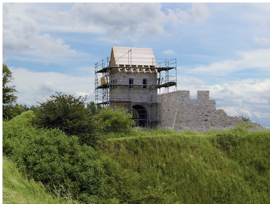
Abb. 11. Werla, Tor II: Blick von außen auf die fertiggestellte Wehrmauer mit Zinnen und dem gezimmerten Dachwerk (Foto: M. C. Blaich, 2012).
