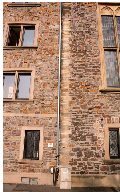
Abb. 10. Blick auf die Baufuge am Übergang vom Haupthaus der 1870er-Jahre (rechts) auf die Rekonstruktion der 1950er-Jahre (links). Die unterschiedliche Zeitstellung ist am Mauerwerkswechsel sowie an der abweichenden Geschossteilung ablesbar (Foto: Verf.).
