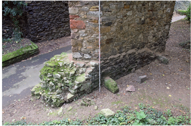
Abb. 6. Befund unterhalb des Brückenpfeilers, eventuell der Pfeiler-Rest einer älteren Brückenkonstruktion (Foto: Verf.).
