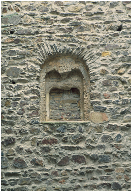
Abb. 7. Die Hoffassade des Südflügels zeigt im ersten Obergeschoss etwa mittig das am aufwändigsten gestaltete Fenster der gesamten Anlage.
