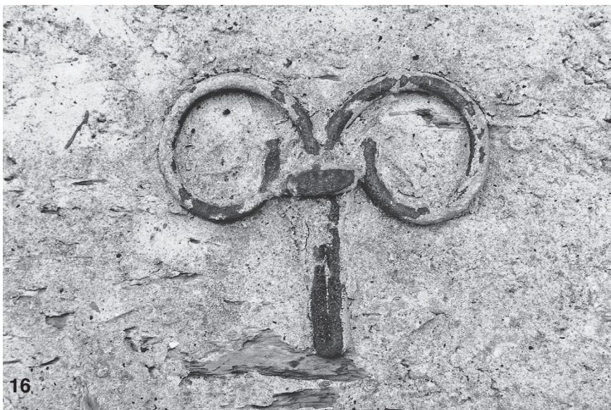
Abb. 16. Das Mauerwerk weist im dritten Obergeschoss zwei verschiedene, nachträglich eingebrachte Ankersysteme auf, bestehend aus vier Anker, die durch den Bergfried gespannt sind, sowie einem Ankerahmen, der vor den Außenwänden verläuft und diagonal durch die Turmkanten geführt ist (Foto: Verf., 2003).
