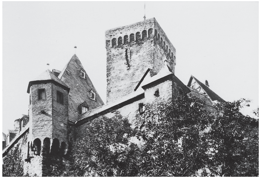
Abb. 3. Das dritte Obergeschoss des Bergfrieds endete 1901 mit einem umlaufenden Bogenfries, auf dem eine niedrige Brüstungsmauer saß. Die Bogen sind stark gestelzt. Unter den äußeren Bogen sind eiserne Zuganker erkennbar (Foto: Messbildanstalt Berlin).
