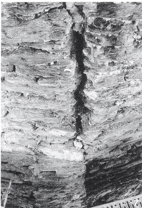
Abb. 6. Marksburg, im untersten Mauerwerksbereich des Kapellenturms weicht das Fundamentwerk vom Verlauf der polygonalen Turmseiten ab (Foto: Verf.).
