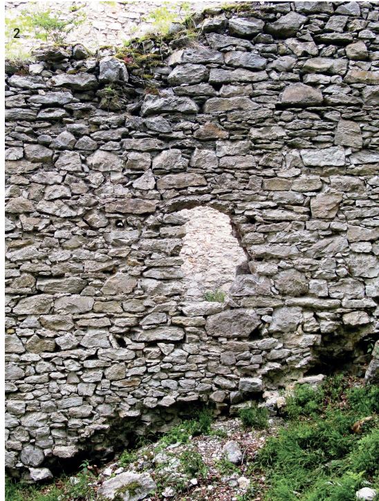
Abb. 2. Ruine Melchingen: Zustand vor der baulichen Sicherung, Außenseite mit schadhafter Fensteröffnung und Fehlstellen im Mauerwerk auf Geländehöhe (Foto: Verf., 2013).
