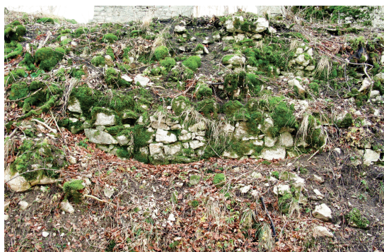
Abb. 8. Ruine Melchingen: Außenseite der im Hangschutt „ersticken“ inneren Westmauer (Ziffer 9 in Abb. 1), die nicht gesichert werden konnte, weil „Schutt entfernen“ verboten war (Foto: Verf., 2011).
