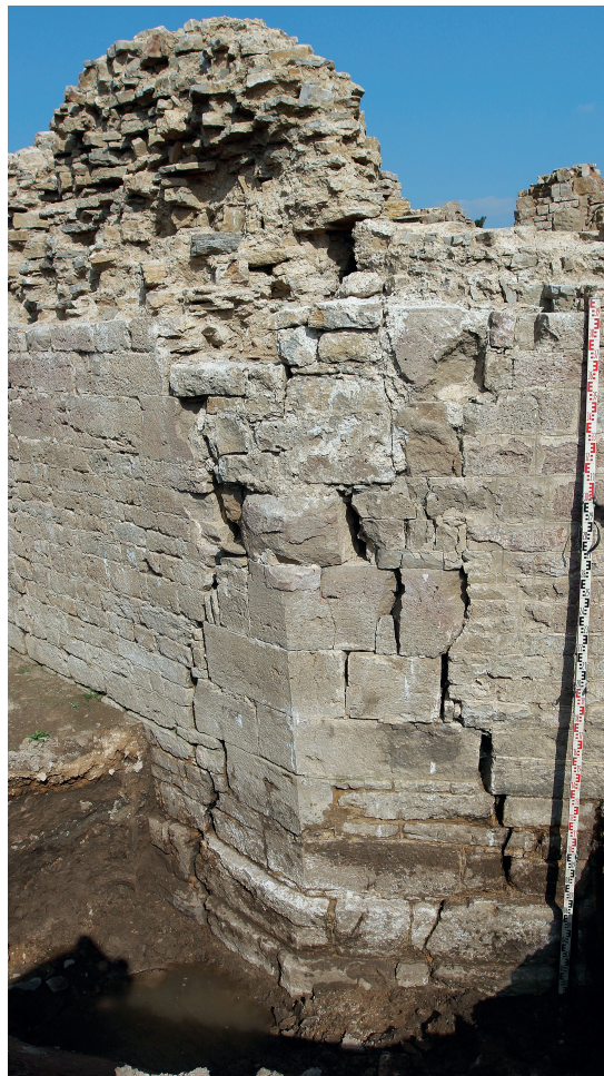
Abb. 15. (Setzungs-)Riss ohne Reparaturspuren, eine Folge von weitergehenden Prozessen nach 1294 (Foto: LWL-Archäologie für Westfalen/M. Thede).
