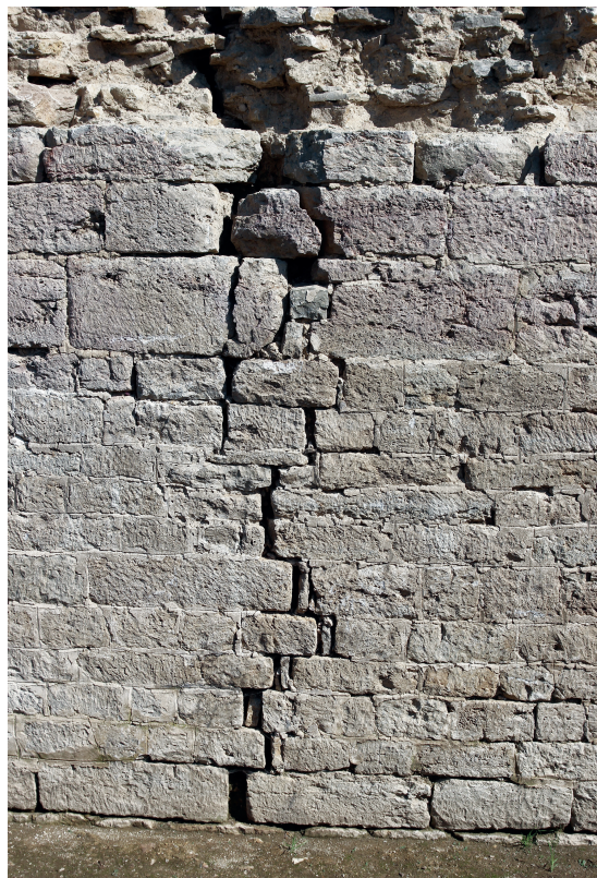
Abb. 13. Riss im Außenmauerwerk des Oktagonsegments (2-7) mit Reparaturspuren (Foto: LWL-Archäologie für Westfalen/M. Thede).
