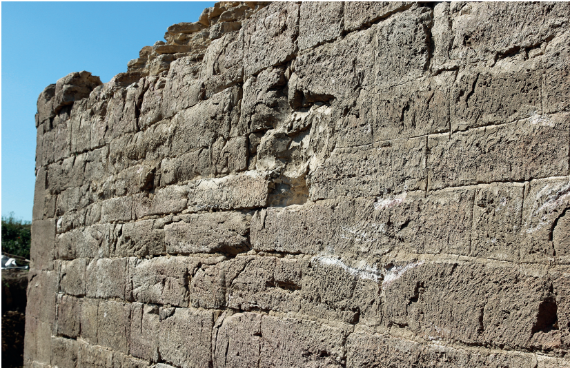
Abb. 16. Schadstelle in Oktagonsegment (2-2) – Resultat eines frühen Blidenbeschusses (?) (Foto: LWL-Archäologie für Westfalen/M. Thede).
