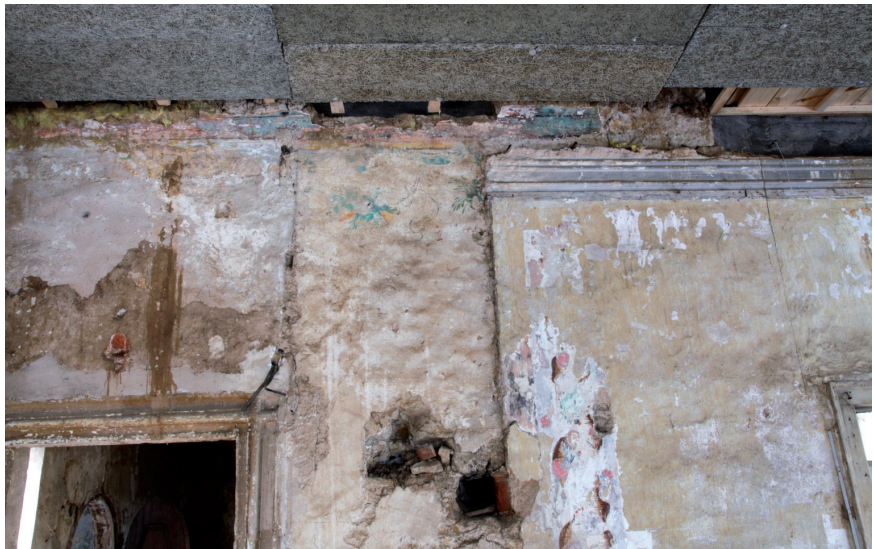
Abb. 10. Saal im ersten Obergeschoss des Nordflügels, Detail der westlichen Wand. Links das ursprünglich rundbogige Portal sowie renaissancezeitliche Fassungsreste (florale Elemente, Hohlkehle); rechts auf einer zusätzlichen Putzschicht die barocken Veränderungen.
