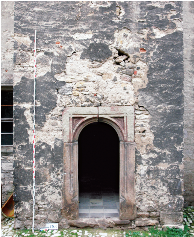
Abb. 5. Im 18. Jahrhundert an Stelle eines Fensters eingefügter Zugang in die ehem. Hofstube im Erdgeschoss; die zweitverwendeten Laibungsblöcke gehörten ursprünglich zum Eingang durch den westlich angrenzenden Vorraum.
