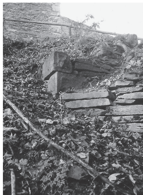
Abb. 14. (rechts) Ebersburg, Ruine, Buckelquadereckverband an der Nahtstelle Wächterhaus – Vorburgmauer (Foto: Rudolph, 2004).
